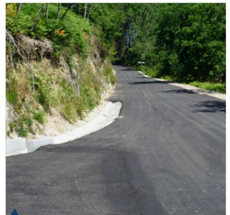
Pavimentação da Estrada da Cruz do Braceiro a Gafanhão - S. Martinho das Moitas
