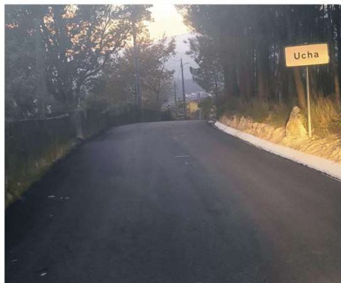
Beneficção da estrada de acesso da Ladreda à Ucha Figueiredo de Alva
