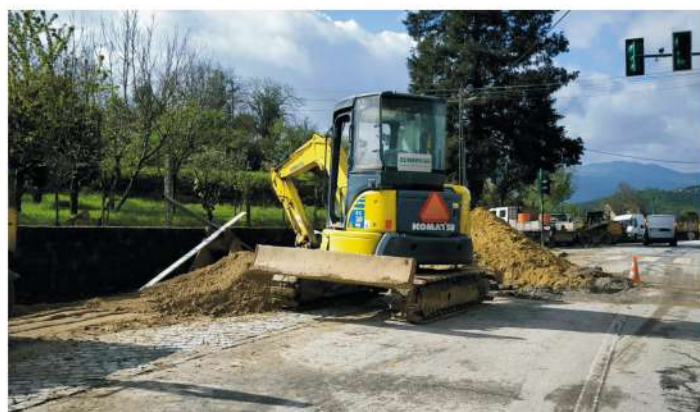
Rede de água e saneamento São Félix
