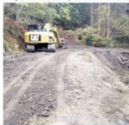
Captação de água Ribeira Cimeira - Vila Maior
