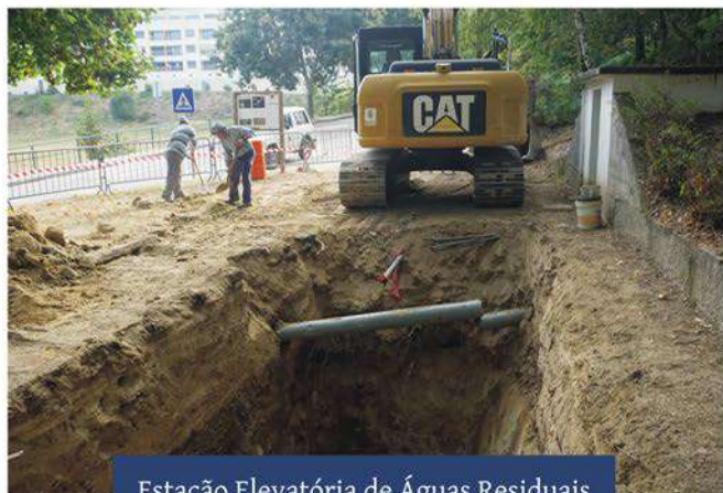
Estação Elevatória de Águas Residuais
