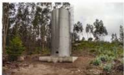
Abastecimento de água à Cidade Massarocas - S. Pedro do Sul
