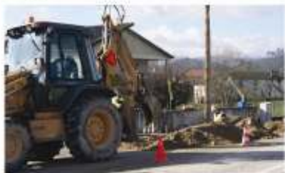
Abastecimento de água e saneamento Várzea - S. Pedro do Sul
